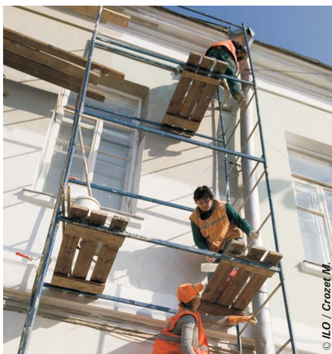
Des travaux de réparation de bâtiments (sans mesures de sécurité adaptées) dans le centre de Moscou (Fédération de Russie)
